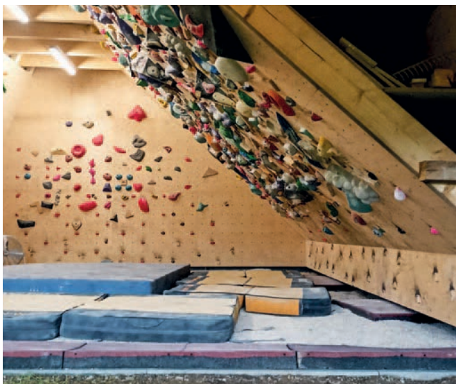
Unzureichend versorgter Mattenstoß (Spalt). Foto: DAV
